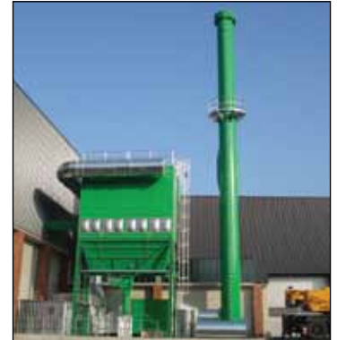
Filteranlage mit Berstscheiben
